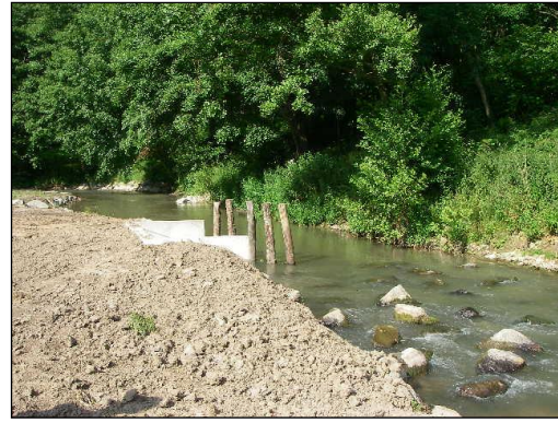
Prise d'eau installée en 2013
